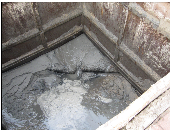
Vanwege het instortingsgevaar werd de ijzeren mal geplaatst
